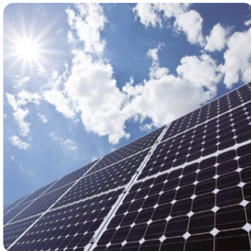
Generering av solcellsenergi hos EVVA
